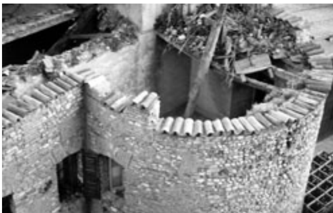
Particolare di una parte delle mura del fortilizio di Vailate e dell'unico torrione rimasto quasi integro. Fotografica scattata prima della ristrutturazione (anno 1980). Proprietà privata.
